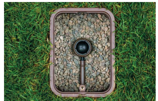
Válvula de Descarga Automática Instalada
