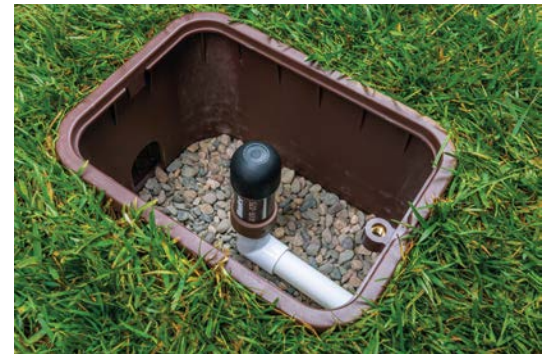
Válvula de Ventosa de Aire/Vacío Instalada
